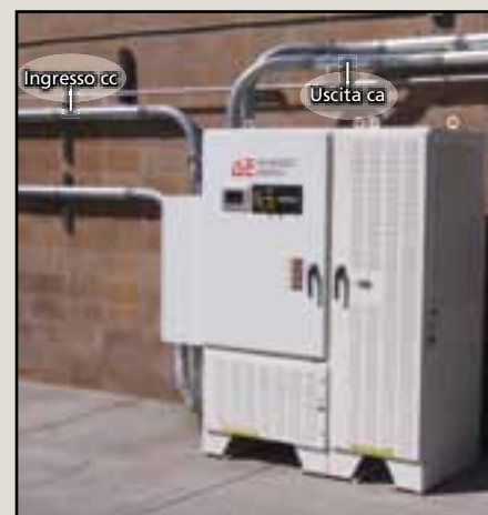
L'invertitore AE Solaron® da 333 kW installato presso Cline Cellars
