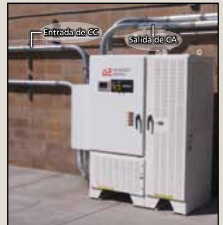
Inversor AE Solaron® de 333 kW instalado en Cline Cellars
